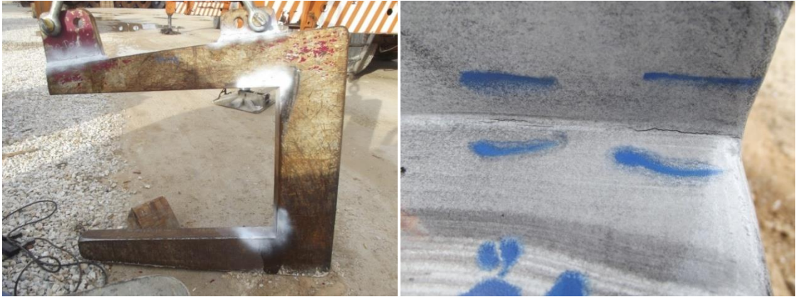
Resim 6-C kanca rulo kaldırma aparatında bulunan çatlaklar
