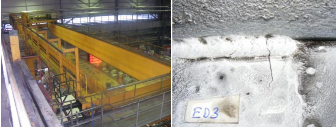
Resim 1-Köprülü vinç konstrüksiyonu ve konstrüksiyonda bulunan çatlak
