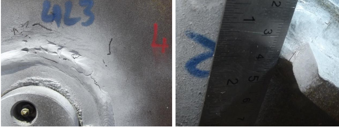
Resim 7-Beton pompası kontrolünde bulunan çatlaklar
