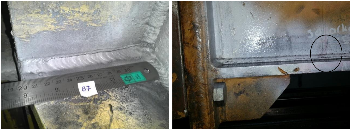
Resim 8-Köprülü vinçlerde bulunan çatlaklar
