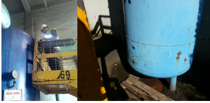
Resim 11-Hava tanklarının kontrolleri ve korozyonlanma
