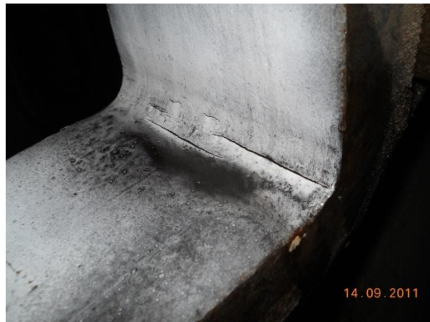
Resim 2-Forklift çatallarında bulunan çatlaklar
