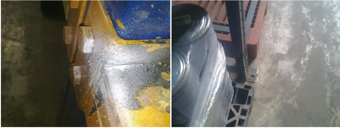
Resim 12-Rafların kontrollerinde bulunan çatlaklar ve plastik deformasyonlar
