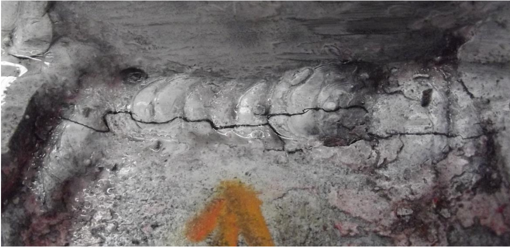
Şekil 13- C kanca kaynaklı tadilat bölgesinde çatlak
