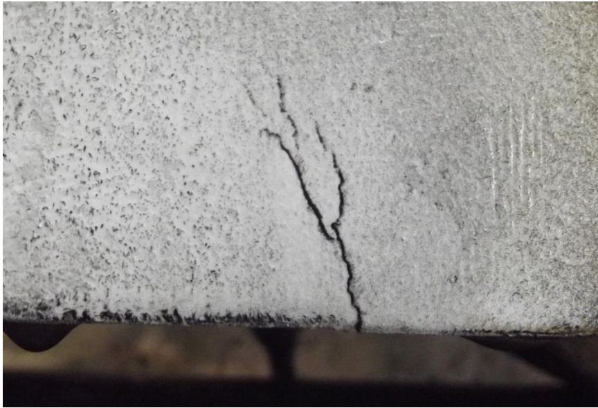
Şekil 4- Vinç Konstrüksiyonu yorulma kontrolü esnasında manyetik parçacık testi ile tespit edilen çatlak
