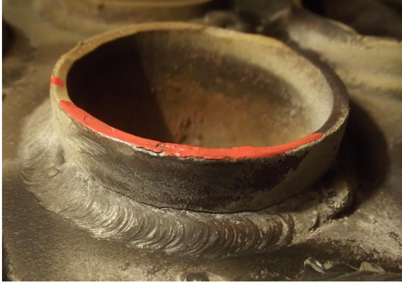
Şekil 12- Buhar kazanı alev duman borusu köşe kaynaklarında çatlak
