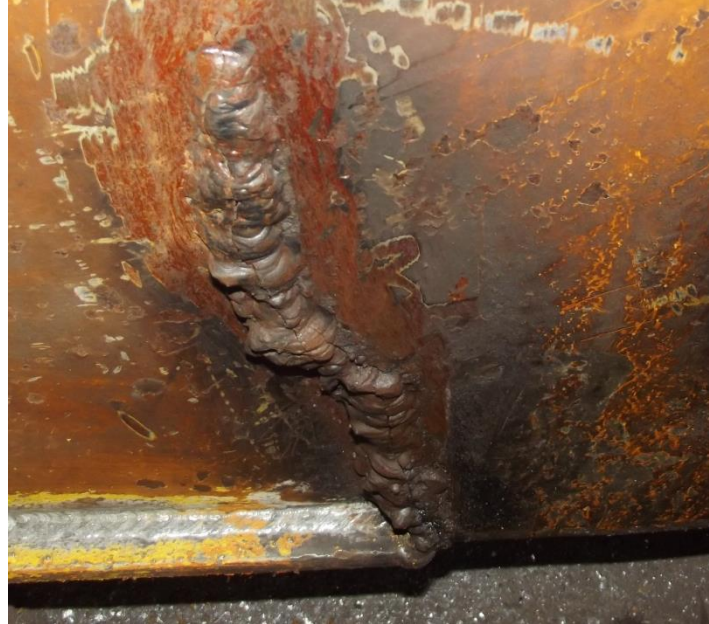
Şekil 8- Vinç konstrüksiyonu yorulma çatlağı ve hatalı tadilat
