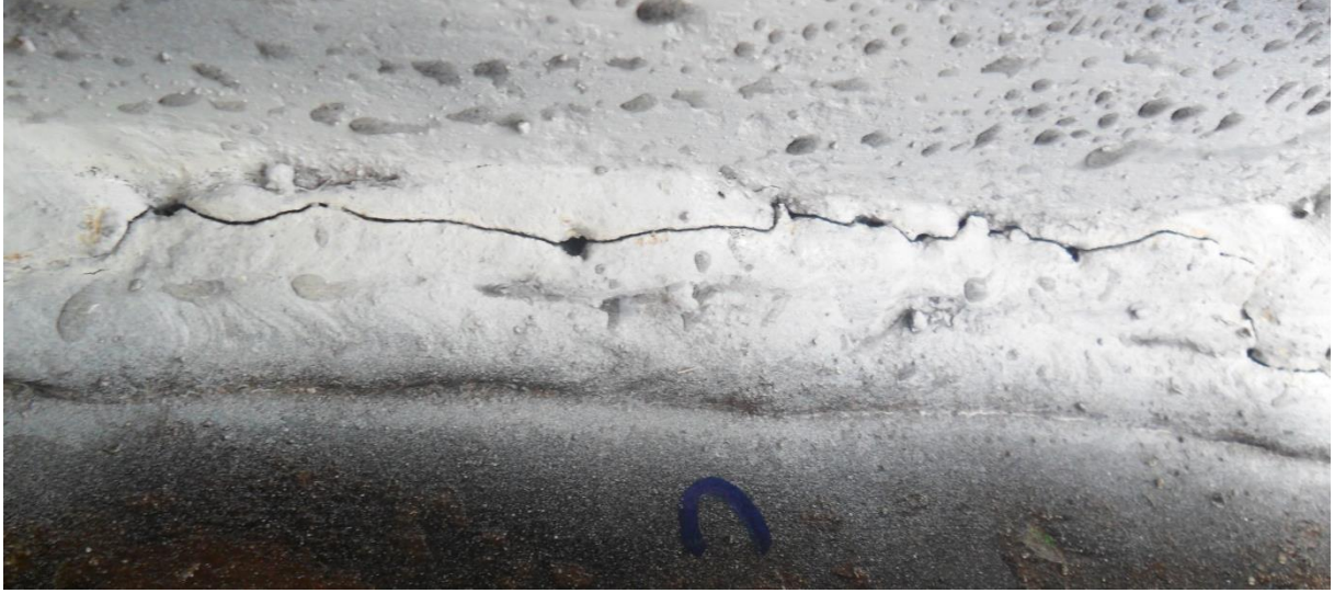
Şekil 14- Konstrüksiyonda yorulma çatlağı
