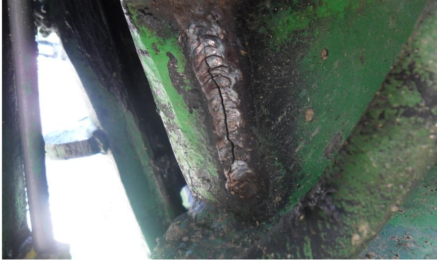
Şekil 6- Uygun olmayan tadilat sonrası yeniden çatlak oluşumu
