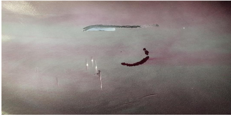
Şekil 5- Paslanmaz çelik basınç kap tadilat bölgesinde çatlak
