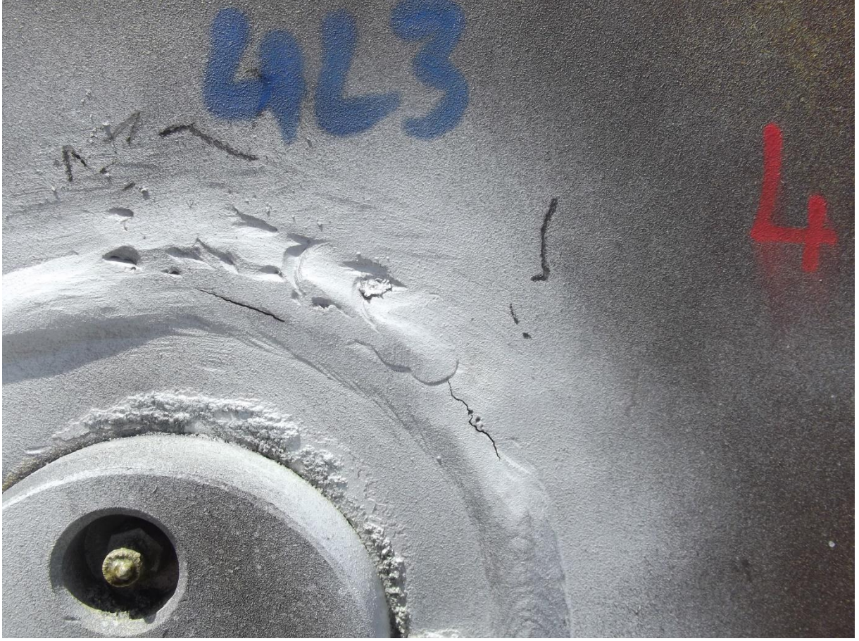
Şekil 15- Beton pompasında yorulma çatlağı ve tadilat bölgesi
